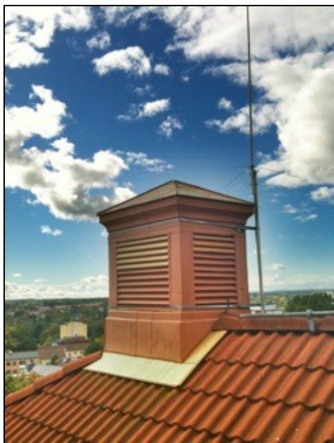
Här är en bild från antenninstallationen på Rävåsskolan söndagen den 19 sept. 2010. Foto: TFE.
